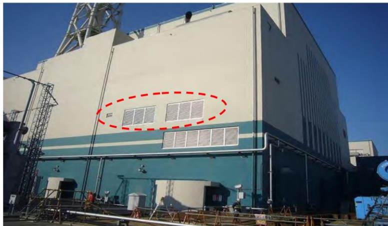
図6-2 非常用ディーゼル発電機電気品区域換気空調系（非常用ディーゼル発電機非常用送風機含む）の外気取入口
