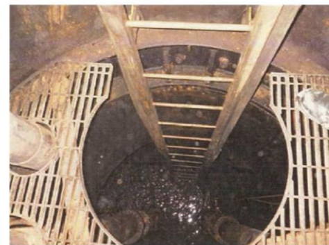
写真C 揚水井戸⑦(下段部) 2017/3/16撮影
