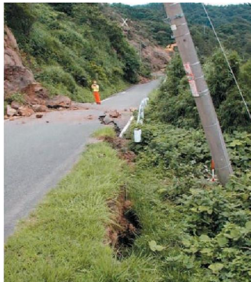
写真2: 受け盤における崩壊
