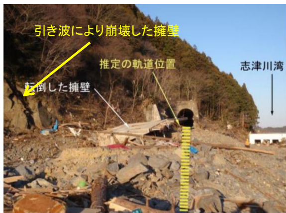
写真1(南三陸町の斜面崩壊状況)
