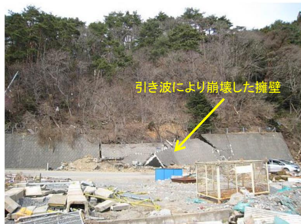
写真2(石巻市雄勝町の斜面崩壊状況)
