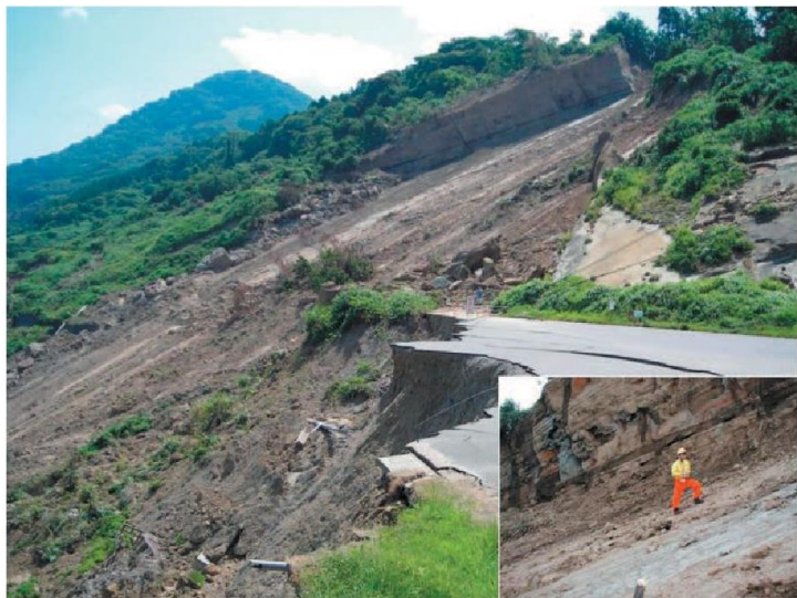
写真1: 流れ盤における崩壊
