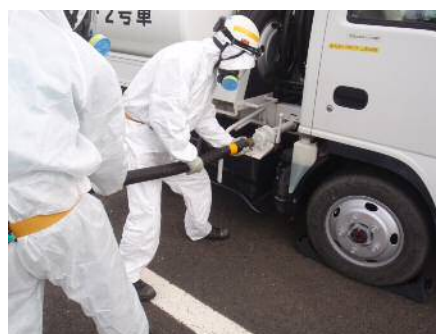
タンクローリへのホース接続
