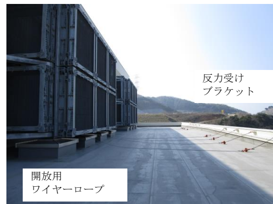
原子炉建物燃料取替階ブローアウトパネル 開放準備状態
