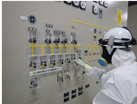
ガスタービン発電機起動操作
