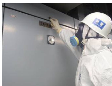
インターロック解除処置
