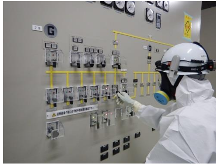
ガスタービン発電機起動操作
