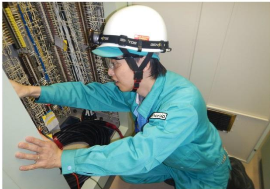
可搬型計測器接続
