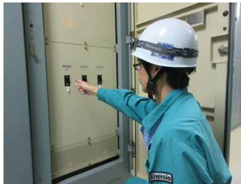
電源切替え操作
