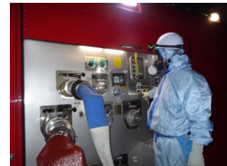
ポンプ起動操作（夜間）
