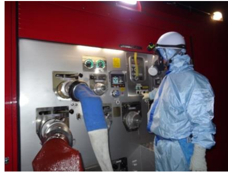
ポンプ起動操作（夜間）
