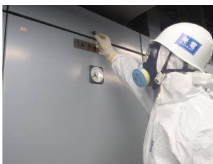
インターロック解除処置
