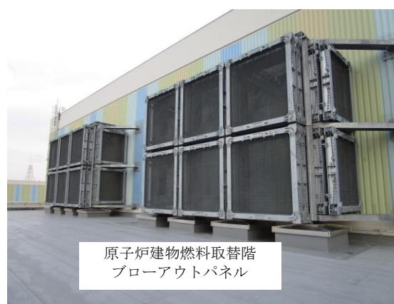
原子炉建物燃料取替階ブローアウトパネル
