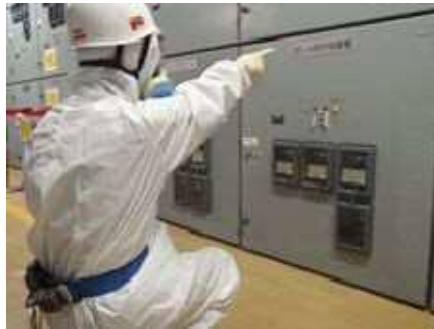
遮断器手動投入
