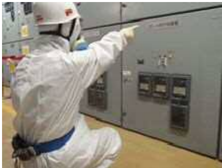
遮断器手動投入
