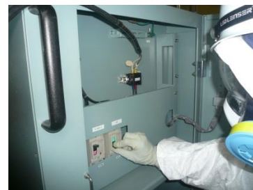
主蒸気逃がし安全弁用 蓄電池の負荷投入操作
