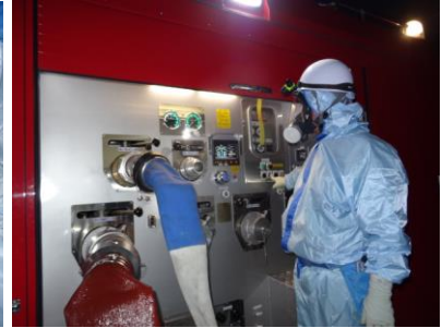
ポンプ起動操作（夜間）
