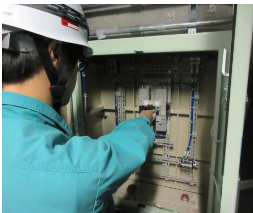
電源切替操作
