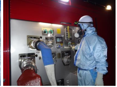
ポンプ起動操作（夜間）
