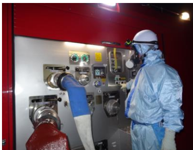
ポンプ起動操作（夜間）
