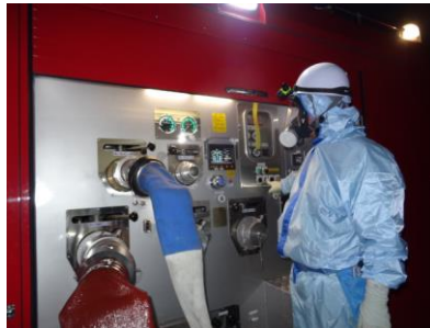
ポンプ起動操作（夜間）
