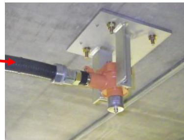
水素濃度検知器（拡大）
