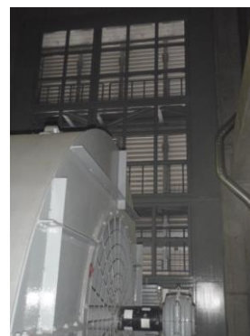
A-非常用ディーゼル発電機室送風機及び火山灰対策（フレイム）
