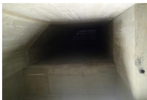
高圧炉心スプレイ系ディーゼル 発電機給気消音器フィルタ室内
