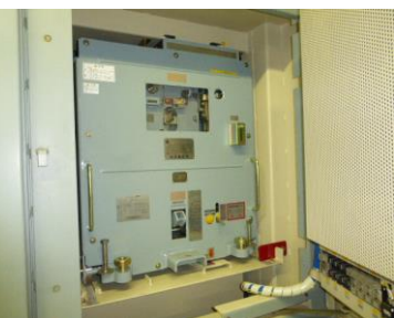
真空遮断器の例 (メタクラ)
