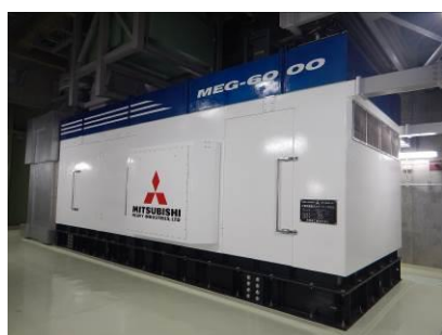
(常設代替交流電源設備の写真)
