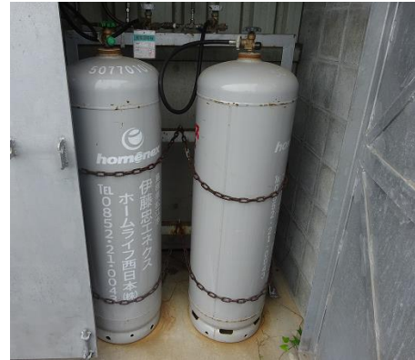
補助ボイラLPGボンベの固縛状況 (補助ボイラLPGボンベ庫)
