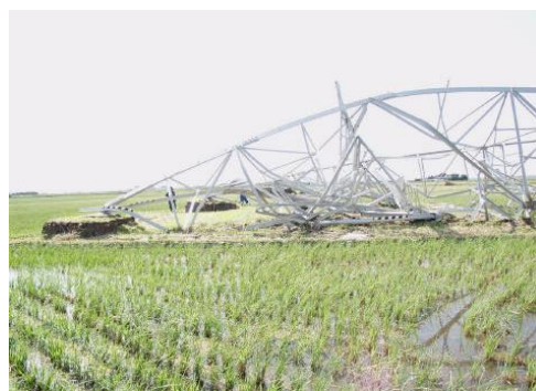
強風による送電鉄塔の倒壊事例② ※1
