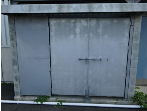
補助ボイラLPGボンベ庫
