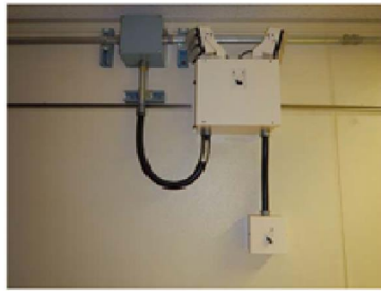
第7図 電源内蔵型照明
