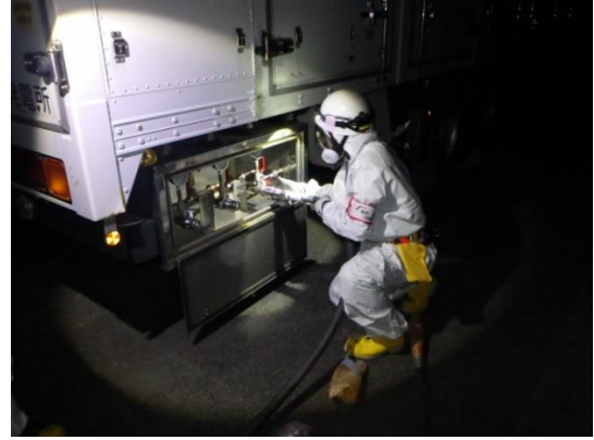
可搬式窒素供給装置 (15m盤 原子炉建物南側)
