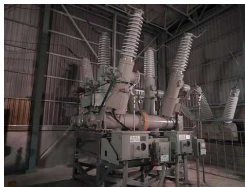
ガス絶縁複合開閉装置（66kV）
