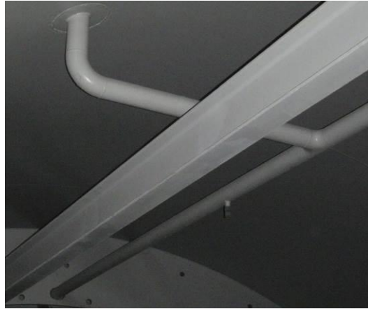
図 2.1.3-2 格納容器スプレイ・ヘッド敷設状況
