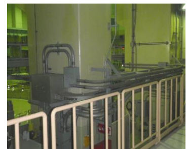
電線管及び端子箱
