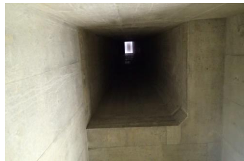
A-非常用ディーゼル発電機 給気消音器フィルタ室内
