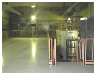
RCW サージタンク及び 計器ラック
