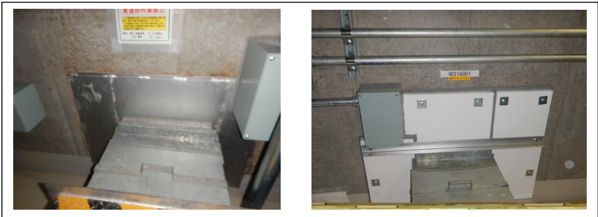
第2図 3時間耐火の貫通部シールを施したケーブルトレイ貫通部の周囲状況
