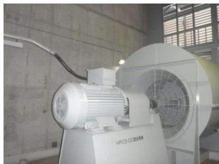
高圧炉心スプレイ系ディーゼル発電機室送風機及び可とう電線管
