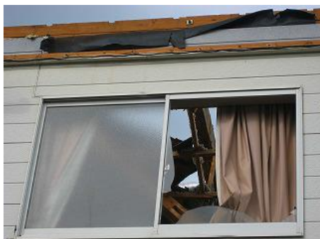
写真 19 窓ガラスの損壊
