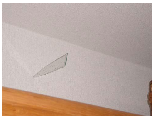
写真 25 破損した窓ガラス片の屋内壁面への突き刺さり[山下町]
