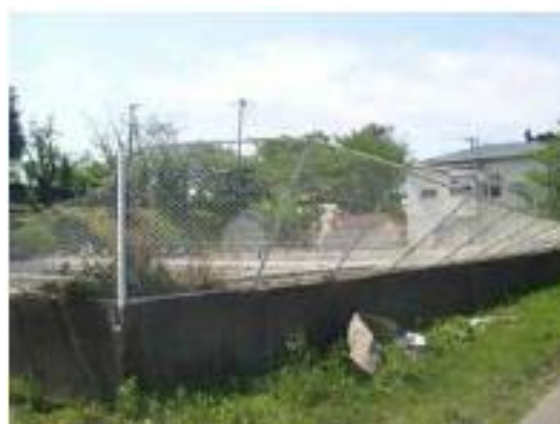
写真3.5-10 フェンスの被害状況
