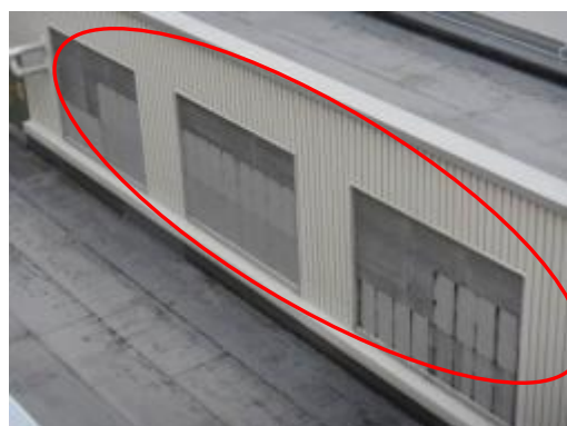
10 1号R/B空調換気系給気用格子
