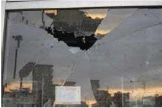
写真 3.4-35 ガラスへの飛来物の衝突痕
