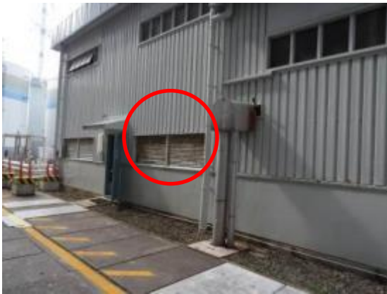
53 純水処理建物給気用格子
