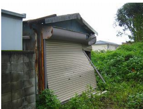
写真 22 シャッターの外れ
