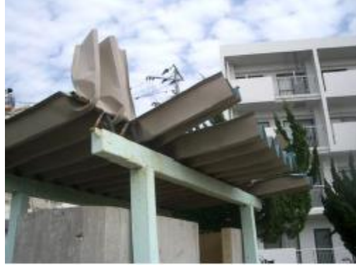
屋外トイレ屋根の損傷
