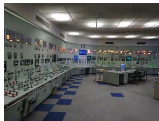
直流非常灯点灯時
