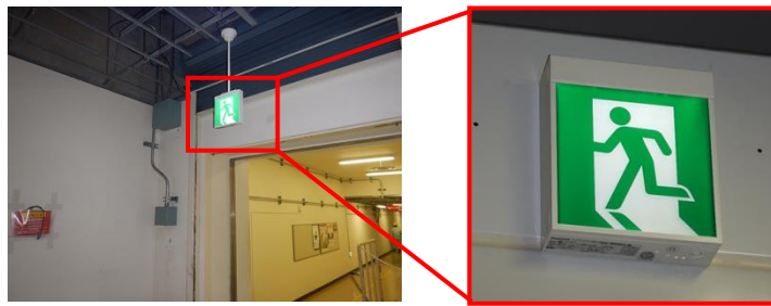
避難口誘導灯
