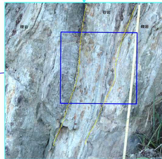
層厚約25cmの砂岩で泥岩を葉片状に挟み、 細かな亀裂が発達している。
