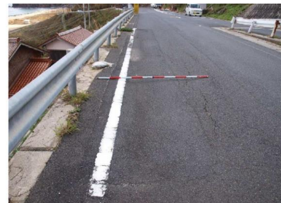
ブロック中央部における路面の変状
