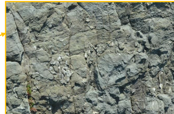
写真12-2 割石島東側岩壁 白色脈の溶脱状況
