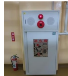
消火器及び消火栓
