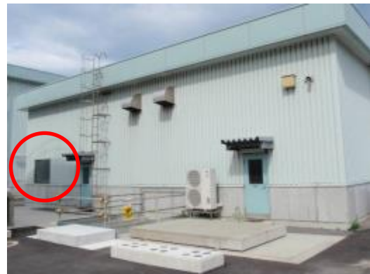
140 給水設備建物西側ガラス窓
