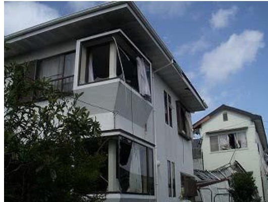
写真 30 出隅部の窓ガラスの被害
