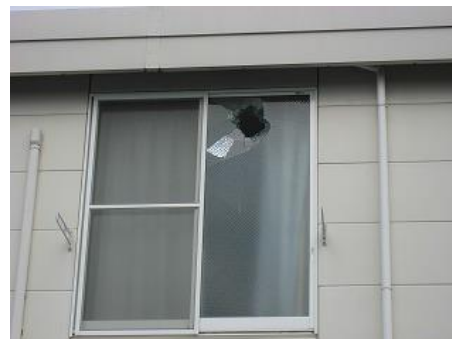
写真 27 窓ガラスの飛来物衝突痕
