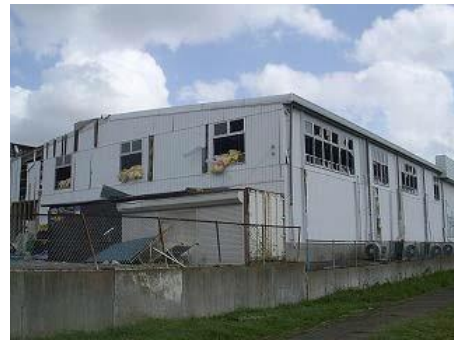
写真 16 窓ガラスの破損
