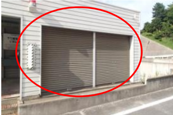
100 エスカレータ南側シャッター（4.4m盤）
