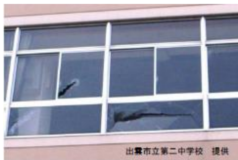
写真 3 体育館窓ガラスの破損
