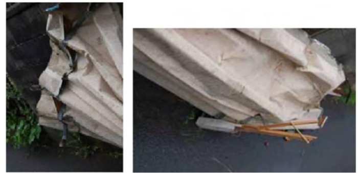
飛散した折板屋根の状況
