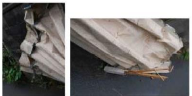
飛散した折板屋根の損傷状況
