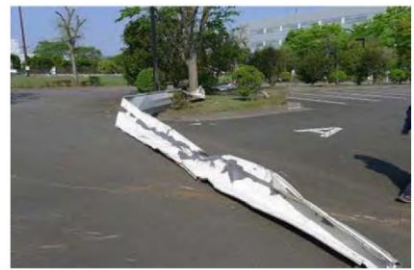
飛散した鋼板製屋根材
