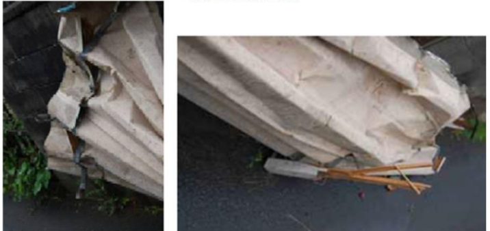
飛散した折板屋根の状況
