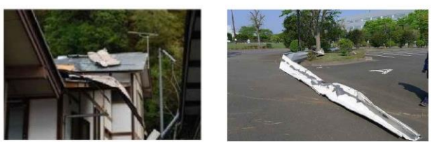
飛来物 (鋼板製屋根材) の衝突
