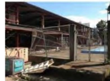
フェンスの被害 (工事中の建築物)
