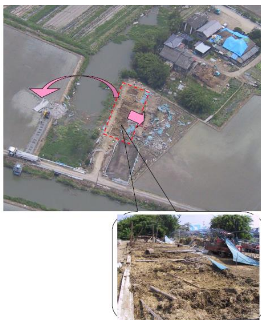
牛舎の屋根東方向、柱・トタン板は西方向に飛散している
