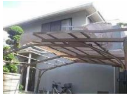
カーボードの被害
