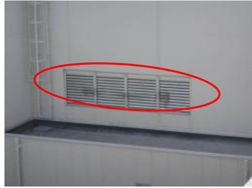
32 中央制御室空調換気系給気用格子
