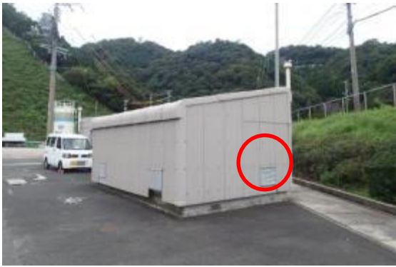
108 危険物屋内貯蔵倉庫給気用格子
