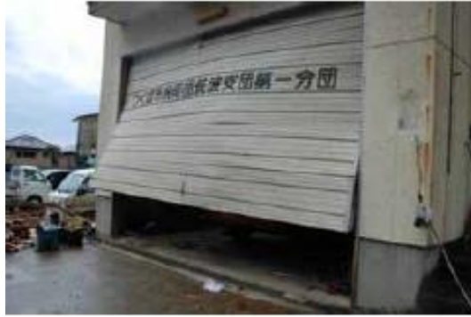
写真 3.4-37 消防団施設のシャッターの被害状況
