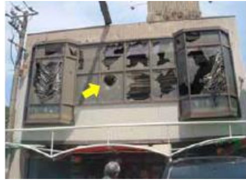
写真 3.4-22 店舗の窓ガラスの被害状況
