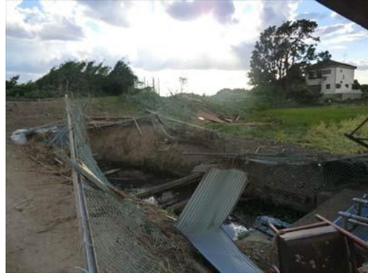
写真 5.1.16 フェンスの被害
