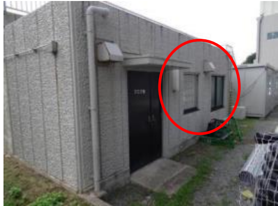
71 プロワ室ガラス窓
