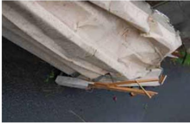
飛散した折板屋根の状況
