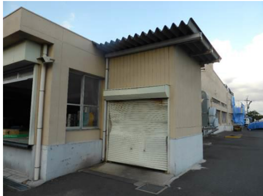
写真 4.1.30 シャッターの変形
