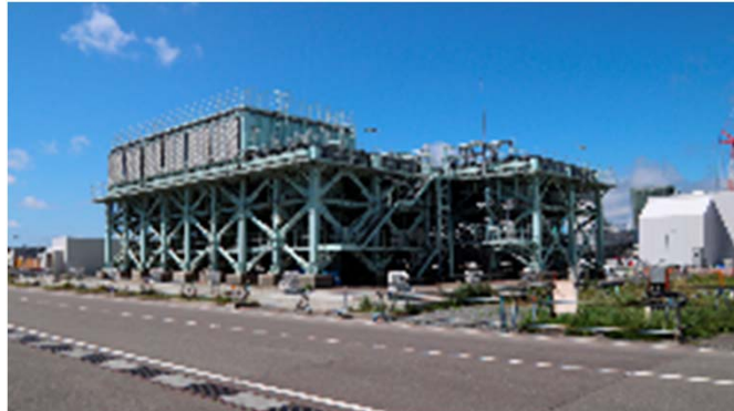
安全冷却水B冷却塔（外観）
