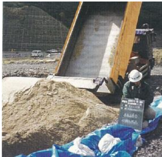
埋戻土(購入土) 現地写真(H11年)
