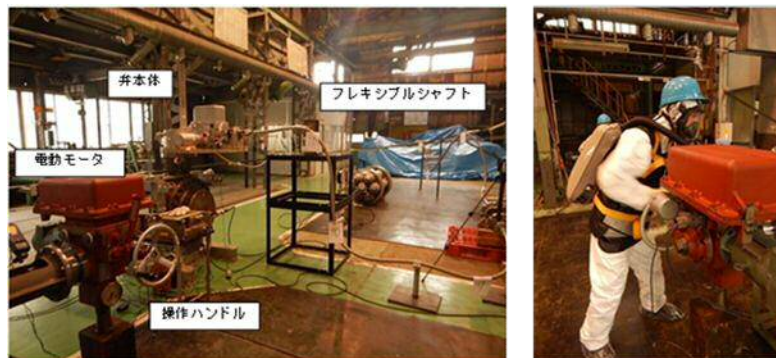
ベント操作（遠隔手動弁操作機構）
