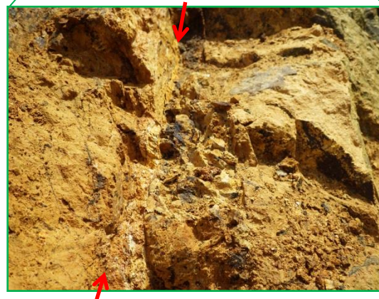
e断層の走向傾斜はN35E70Nであり、部分的に風化変質により軟質化した箇所が認められる。
