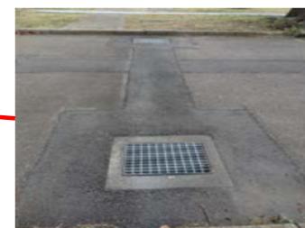
雨水排水溝 (グレーチング)
