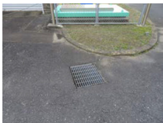
雨水排水溝 (グレーチング)
