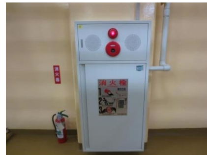
消火器及び消火栓
