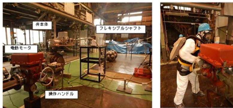
ベント操作（遠隔手動弁操作機構）
