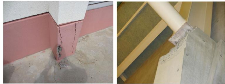
柱脚部コンクリートのひび割れ
