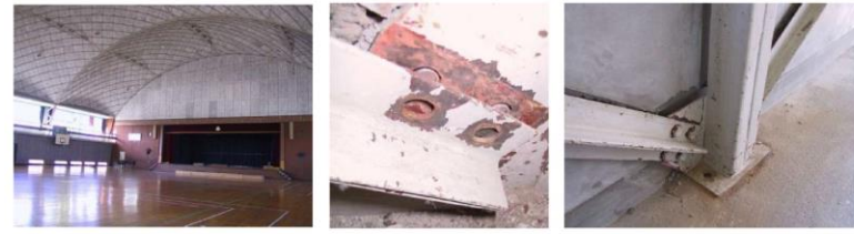
内観 筋かい材ボルト破断 間柱脚部アンカーボルト破断
