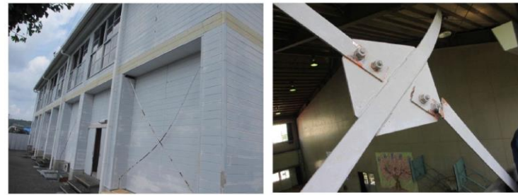
筋かい材の変形
