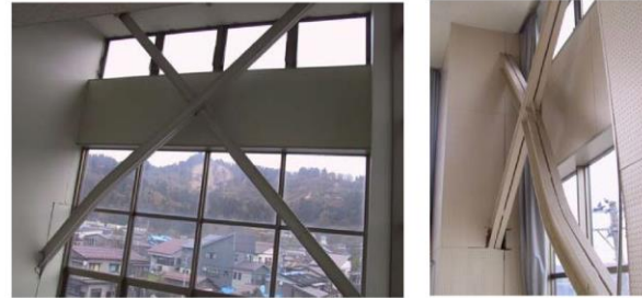
ブレース材の座屈
