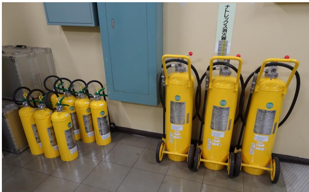
可搬型消火器の形状で保管
