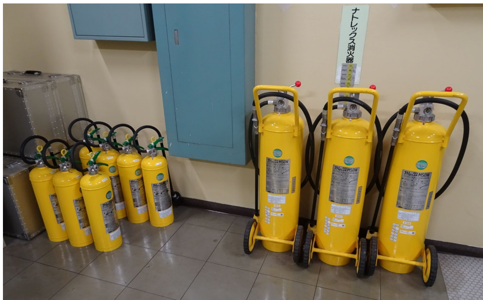
可搬型消火器の形状で保管
