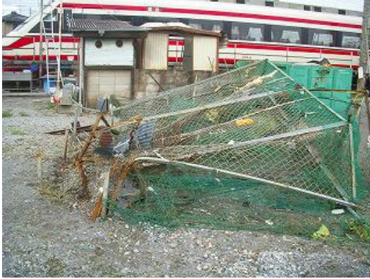
写真20 フェンスの著しい変形
