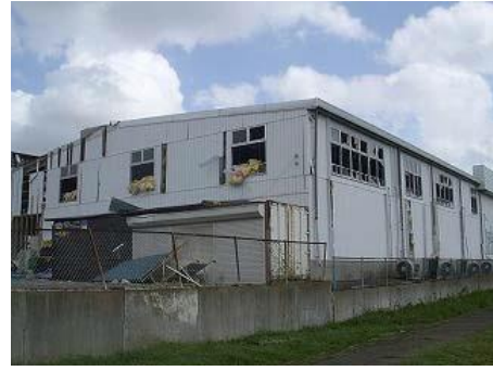
写真 16 窓ガラスの破損
