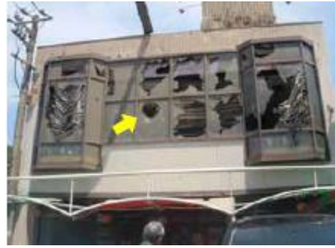
写真 3.4-22 店舗の窓ガラスの被害状況
