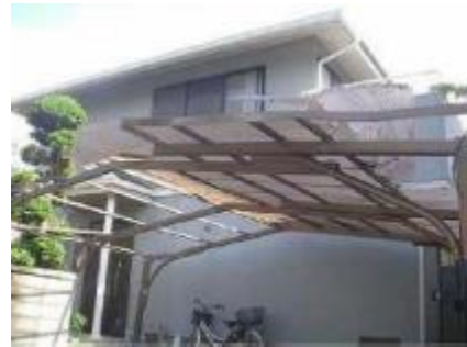
カーボードの被害
