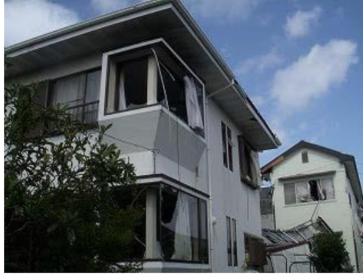
写真 30 出隅部の窓ガラスの被害
