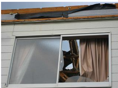
写真 19 窓ガラスの損壊
