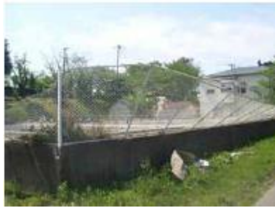
写真3.5-10 フェンスの被害状況
