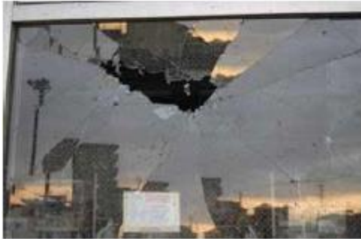
写真 3.4-35 ガラスへの飛来物の衝突痕
