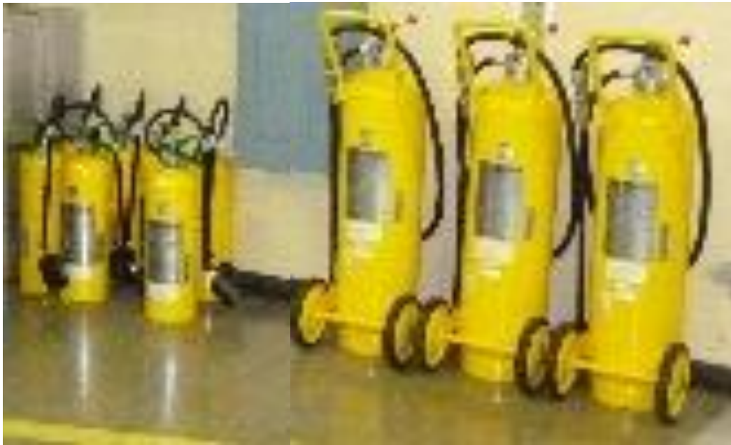
可搬型消火器の形状で保管
