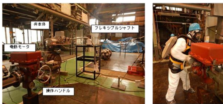
ベント操作（遠隔手動弁操作機構）
