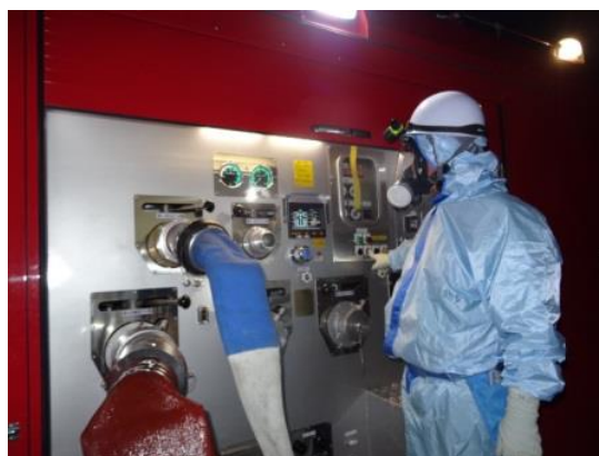
ポンプ起動操作（夜間）
