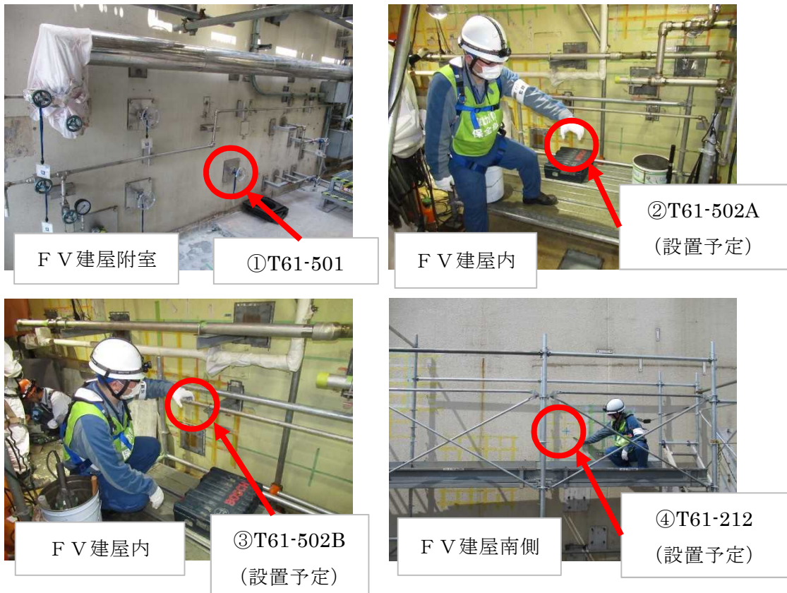
図2 操作バルブ写真
