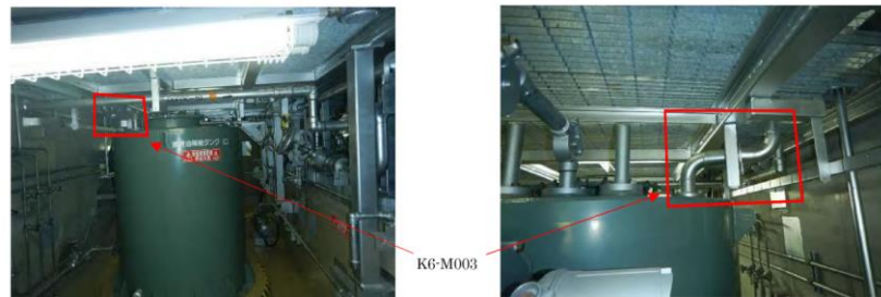
第1-3図 現場状況写真 (潤滑油補給タンク周辺)
