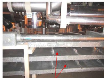
金属製の密閉ダクト (蓋付きケーブルトレイ)
