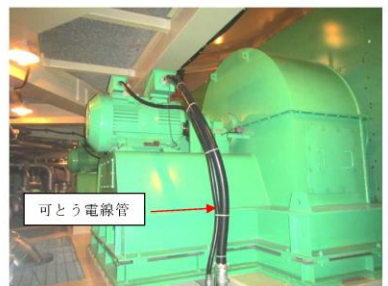
機器へのケーブル取合い状況 (D/W冷却機との取合い)
