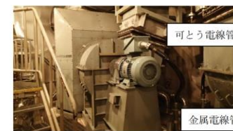
機器へのケーブル取合 (ドライウェル冷却機との取合)
