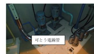
機器へのケーブル取合 (サンポンプ、レベル計との取合)
