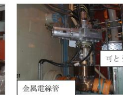
機器へのケーブル取合 (電動弁との取合)
