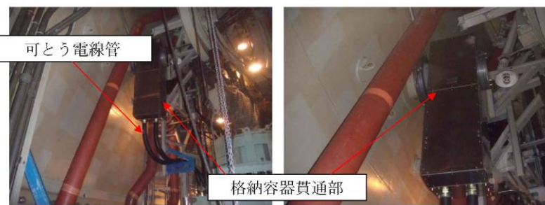
機器へのケーブル取合状況 (格納容器貫通部と電線管との取合)
