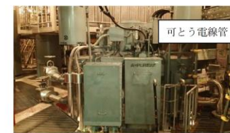
機器へのケーブル取合 (原子炉再循環ポンプ用電動機との取合)
