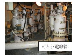
機器へのケーブル取合 (主蒸気速がし安全弁との取合)
