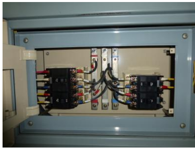
気中遮断器の例 (ブレーカ)
