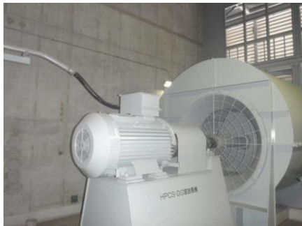
HPCSディーゼル室送風機 及び可とう電線管
