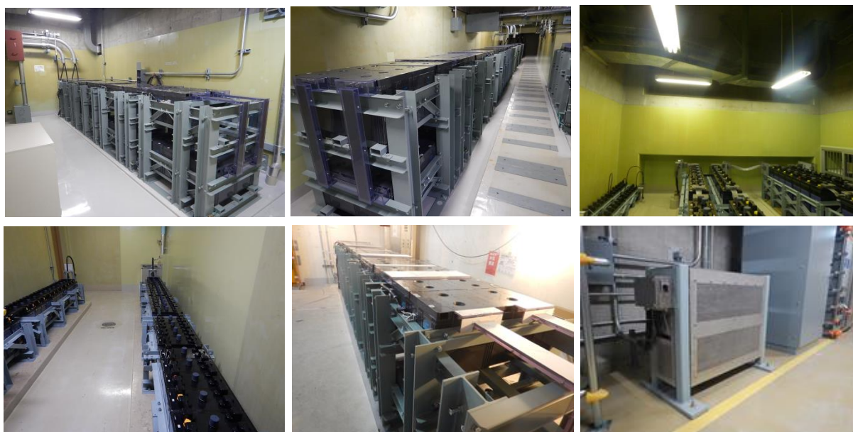
第1-39図 蓄電池の設置状況 (1 / 7)
