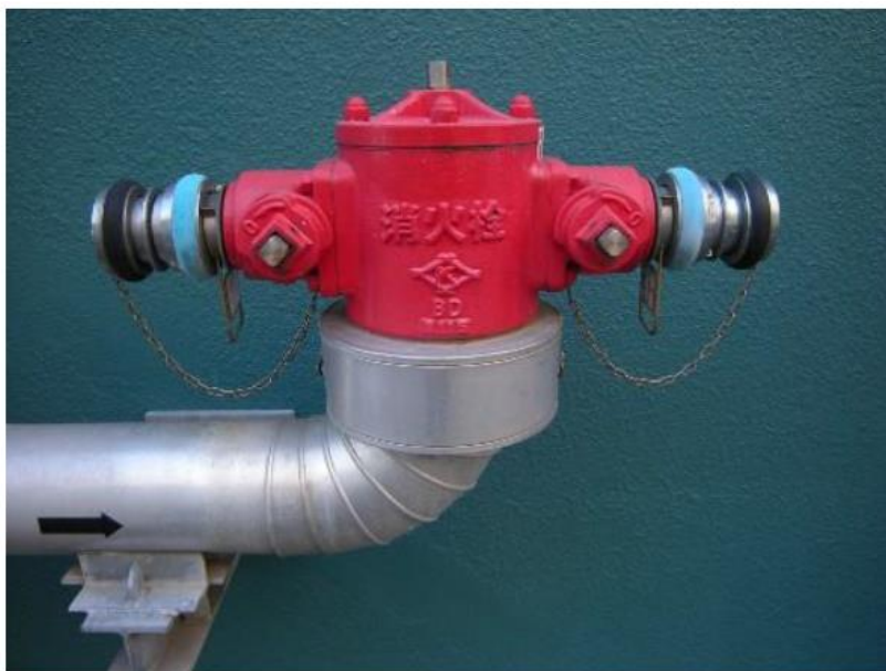
第 1-32 図：不凍式消火栓の設置状況
