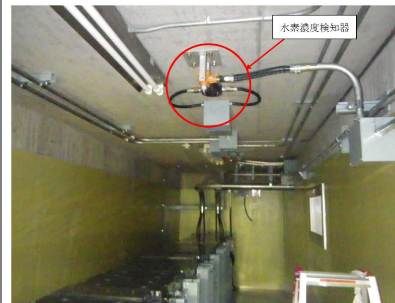
第 1-6 図 (2) 蓄電池室の水素濃度検知器設置状況
