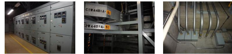
電源盤 ケーブルトレイ 電線管
