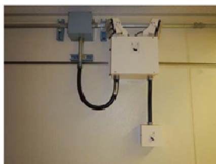
第7図 電源内蔵型照明
