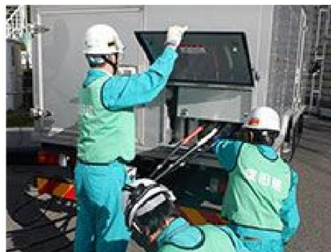
高圧発電機車を用いた電源供給訓練の状況 （写真は全交流電源喪失時を想定した電源ケーブル接続作業）
