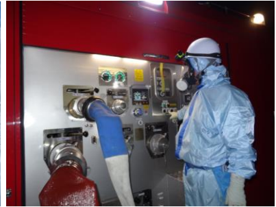
ポンプ起動操作（夜間）
