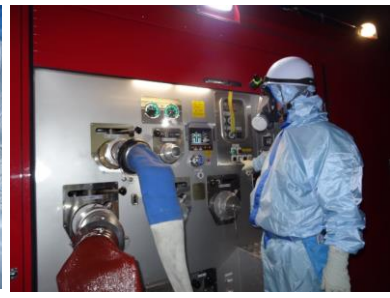
ポンプ起動操作（夜間）
