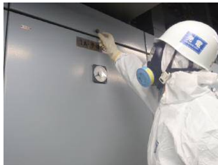
インターロック解除処置
