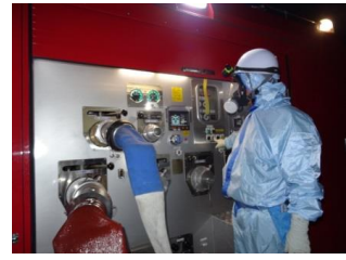
ポンプ起動操作（夜間）
