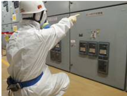
遮断器手動投入
