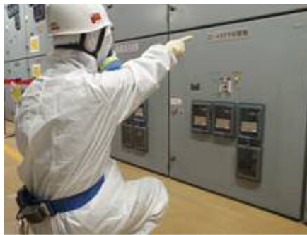
遮断器手動投入
