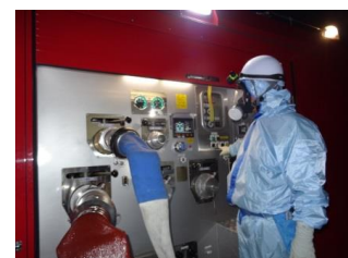
ポンプ起動操作（夜間）
