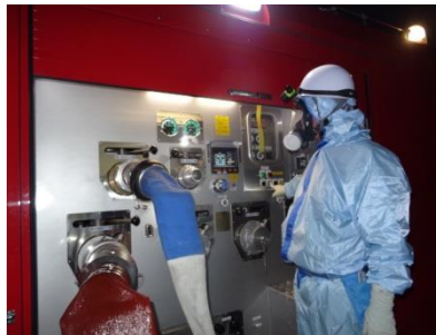
ポンプ起動操作（夜間）
