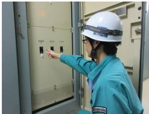
電源切替操作
