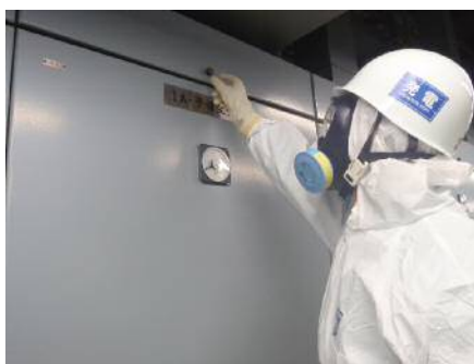
インターロック解除処置
