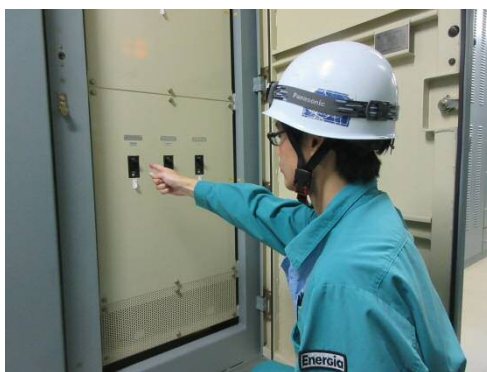
電源切替操作
