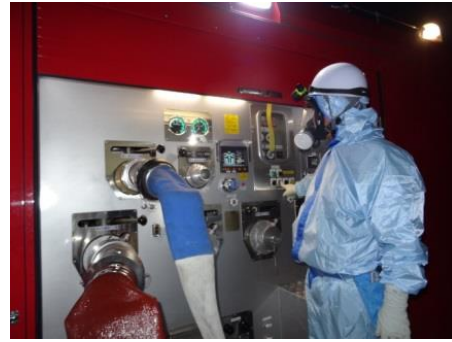
ポンプ起動操作（夜間）
