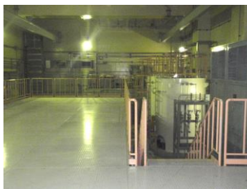
RCW サージタンク及び 計器ラック
