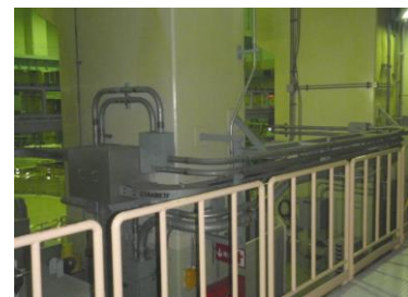
電線管及び端子箱
