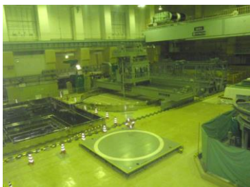
原子炉建物天井クレーン 及び燃料取替機
