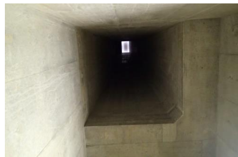
A-給気消音器フィルタ室内
