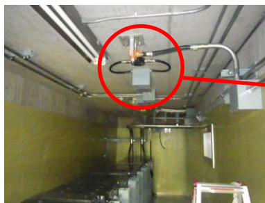
水素濃度検知器（蓄電池室の例）
