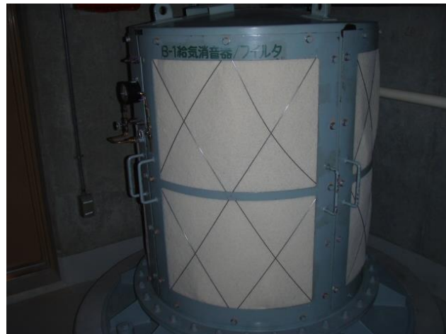
第41-1-11図 ディーゼル発電機給気消音器フィルタ室の概要
