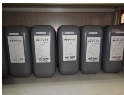
第3図 泡消火薬剤 1000 リットル
