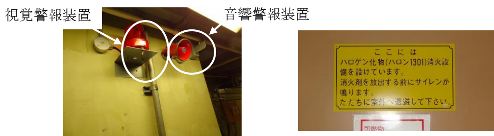
第41-1-25図 全域ガス消火設備（ハロン1301）の職員退避警報装置の例
