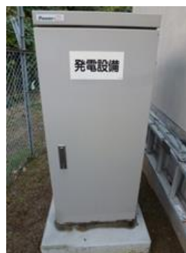
(非常用発電機の写真)
