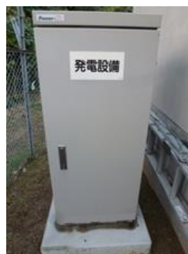
(非常用発電機の写真)
