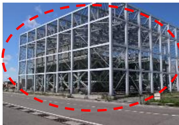
安全冷却水B冷却塔 飛来物防護ネット
