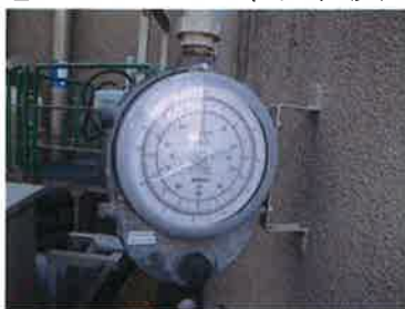
図 1 復水タンク水位計
